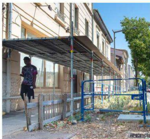
Un tunnel de sécurité a été installé au 189 route de Vienne à la suite de la fissuration puis l'écroulement d'une partie de l'immeuble la semaine passée. Photo Cyril Lestage
