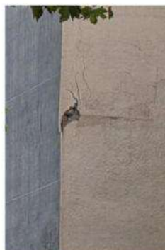
Les fissures sur le mur sont visibles depuis la rue Cabias. Photo Régis Barnes
