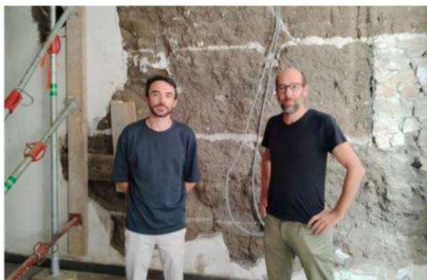
Simon Bourrat et Alain Montfort, deux des six copropriétaires, devant le mur porteur fissuré. Photo Yves Le Flem
